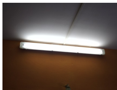
Figura 8.12 - Particolare impianto illuminazione su cui intervenire.
