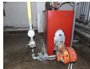
Figura 8.7 – Particolare di uno dei generatori da sostituire
