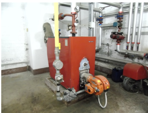
Figura 4.11 - Generatori di calore
