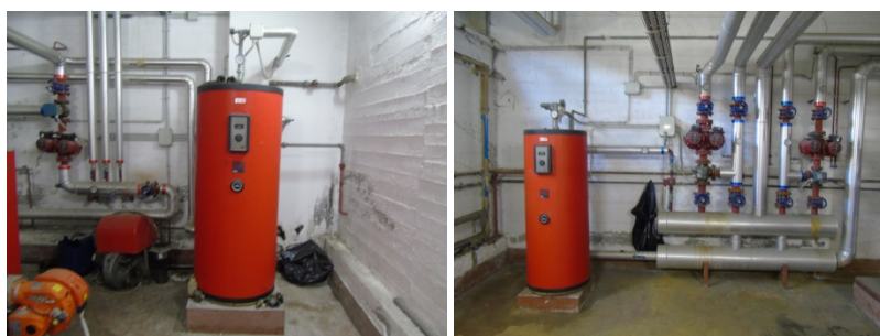
Figura 4.13 - Particolare dei sistemi di accumulo dell'ACS posizionati nelle due centrali termiche
