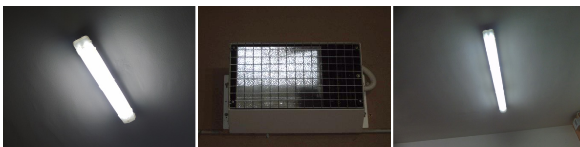
Figura 4.14 - Particolare dei corpi illuminanti
