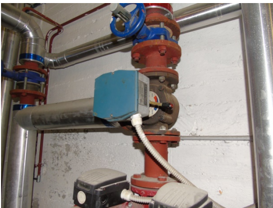
Figura 4.7 - Particolare valvola miscelatrice asilo nido
